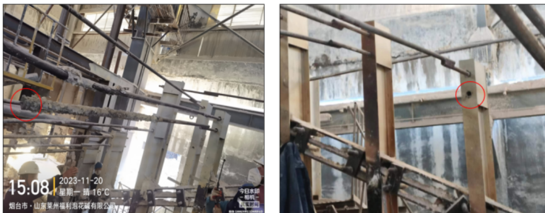
图 9 9#拉条断裂情况
