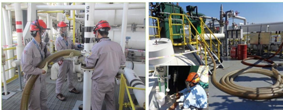
检修时废气软管收集设施
