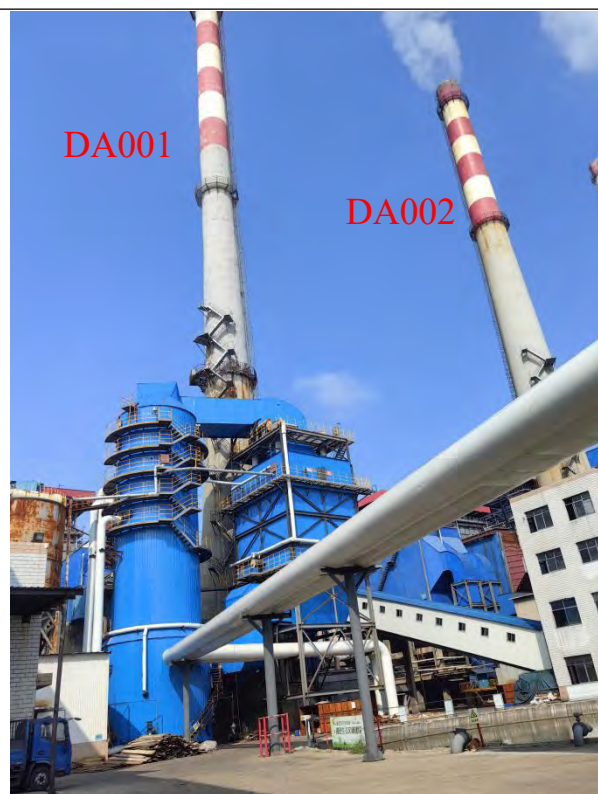
锅炉烟囱 DA001、DA002
