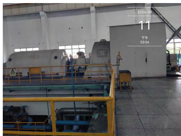
汽机房 (1×C25MW 抽凝机组)
