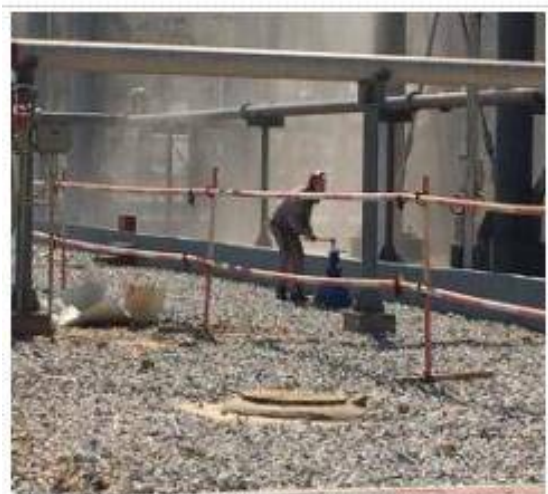
事故废水切换至消防事故池
