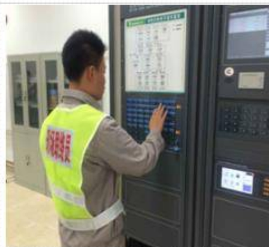
打开控制室消防柜现场雨淋阀开关
