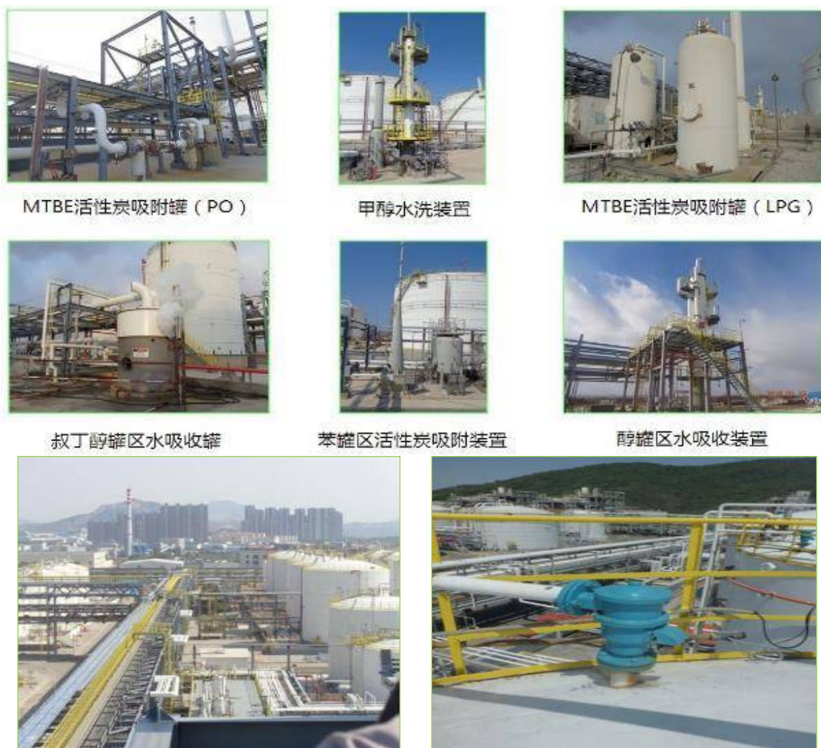
图2.2-14 储罐安全阀排气收集
