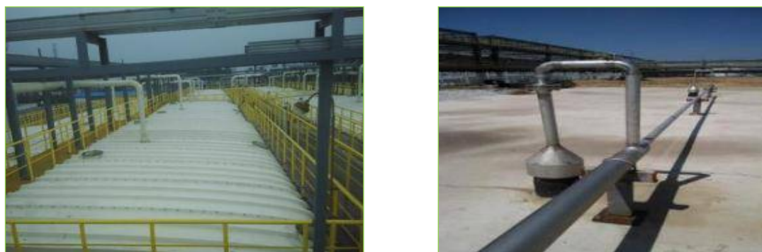
图2.2-17 污水处理系统、污水池废气收集设施
