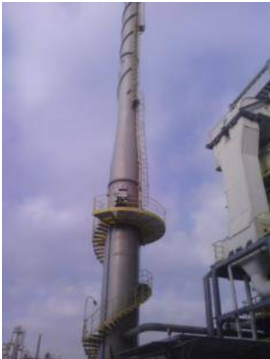
图2.2-13 1#MMA 废水焚烧炉外貌图
