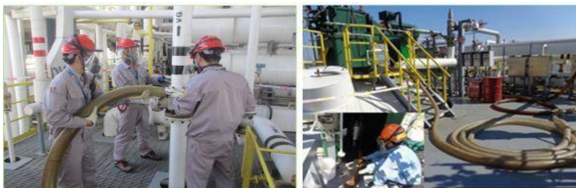
图2.2-15 检修时废气软管收集设施
