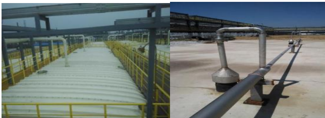
图 3.2-6 污水处理系统、污水池废气收集设施
