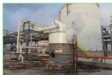
叔丁醇罐区水吸收罐
