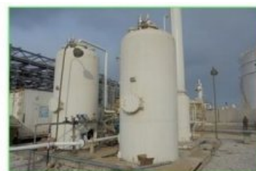
MTBE活性炭吸附罐（LPG）
