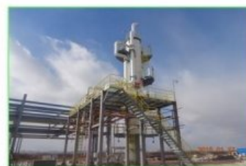
醇罐区水吸收装置
