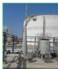
苯罐区活性炭吸附装置
