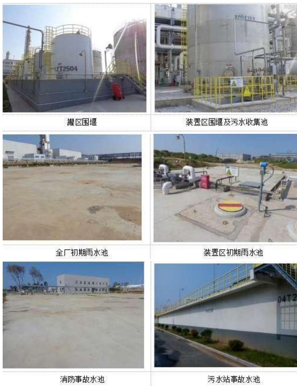
图 7.1-2 现有工程水环境风险防范设施
