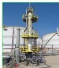
甲醇水洗装置
