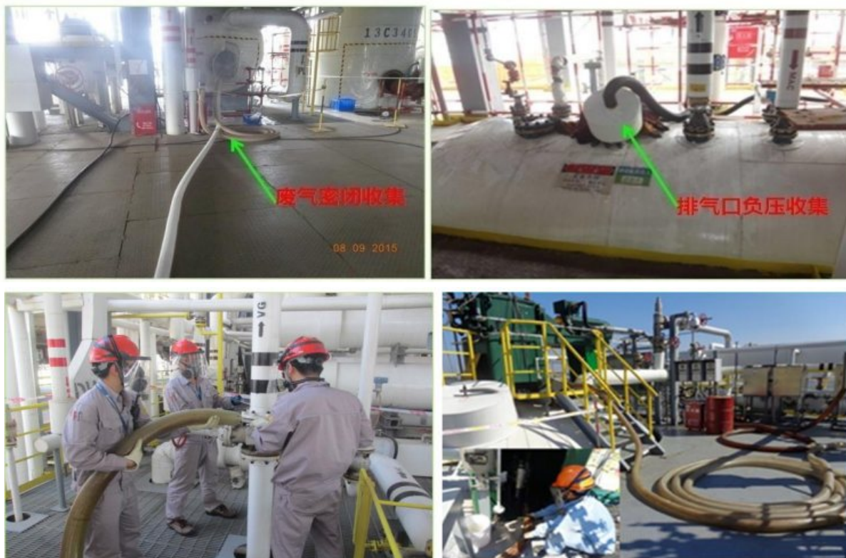
图 3.2-4 检修时废气软管收集设施
