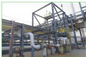
MTBE活性炭吸附罐（PO）
