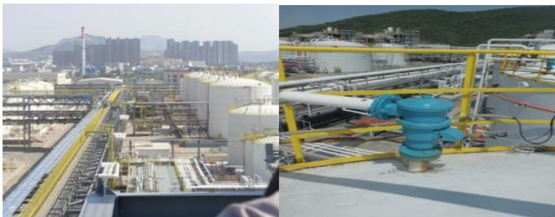
图 3.2-3 储罐安全阀排气收集
