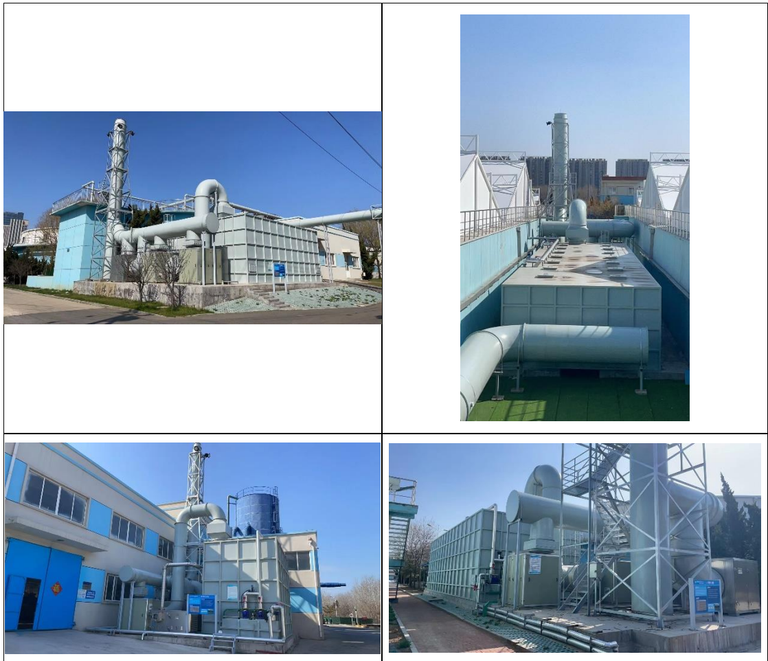
图 4-1 现有厂区除臭系统
