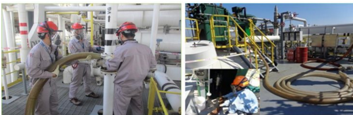
图 3.2-4 检修时废气软管收集设施
