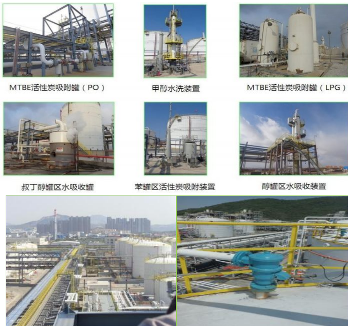
图 3.2-3 储罐安全阀排气收集
