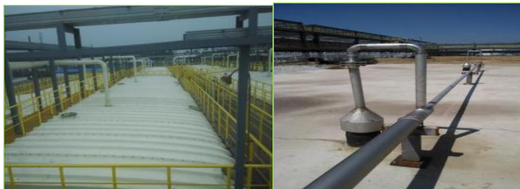
图 3.2-6 污水处理系统、污水池废气收集设施
