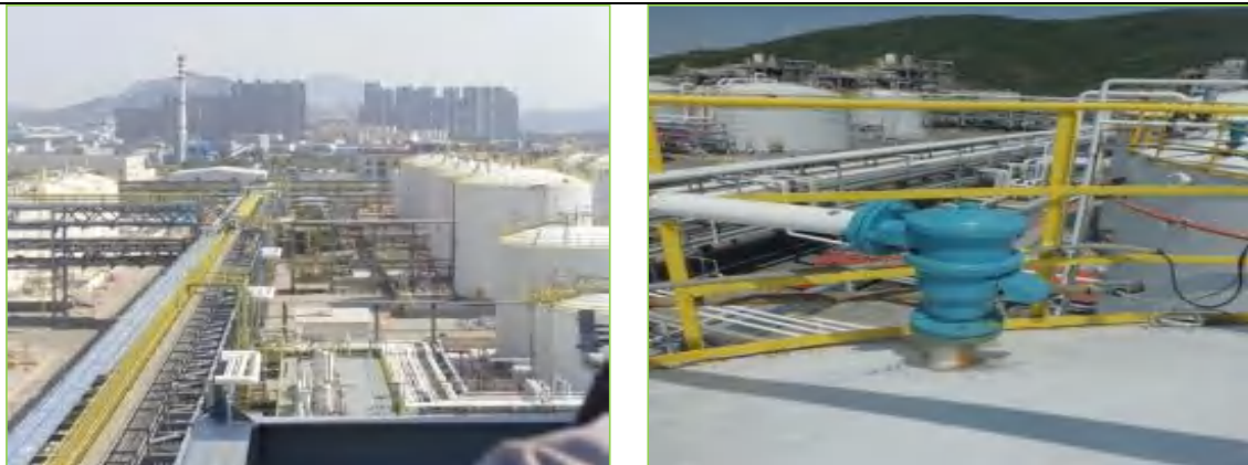
图 2.2-4 储罐安全阀排气收集
