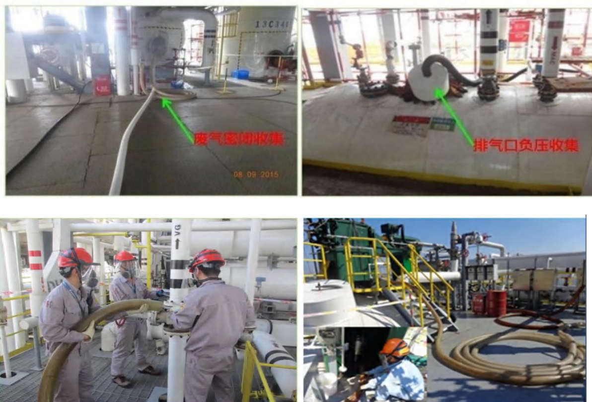
图 2.2-5 检修时废气软管收集设施
