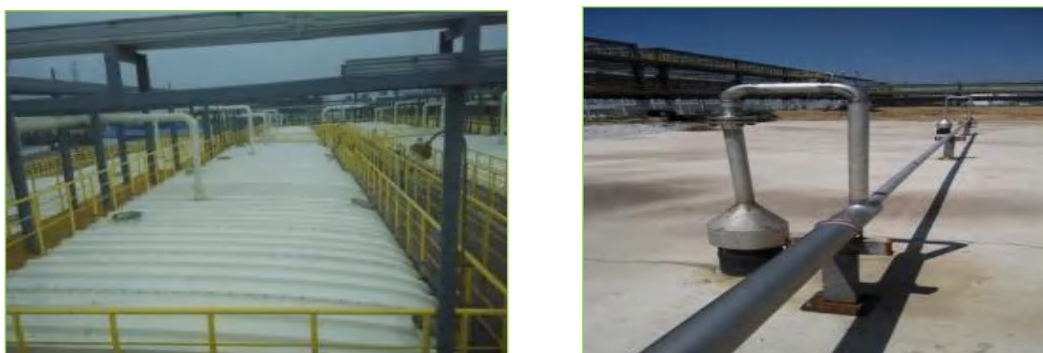
图 2.2-7 污水处理系统、污水池废气收集设施
