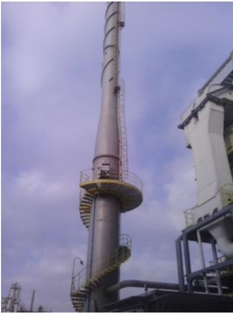
图 2.2-3 1#MMA 废水焚烧炉外貌图
