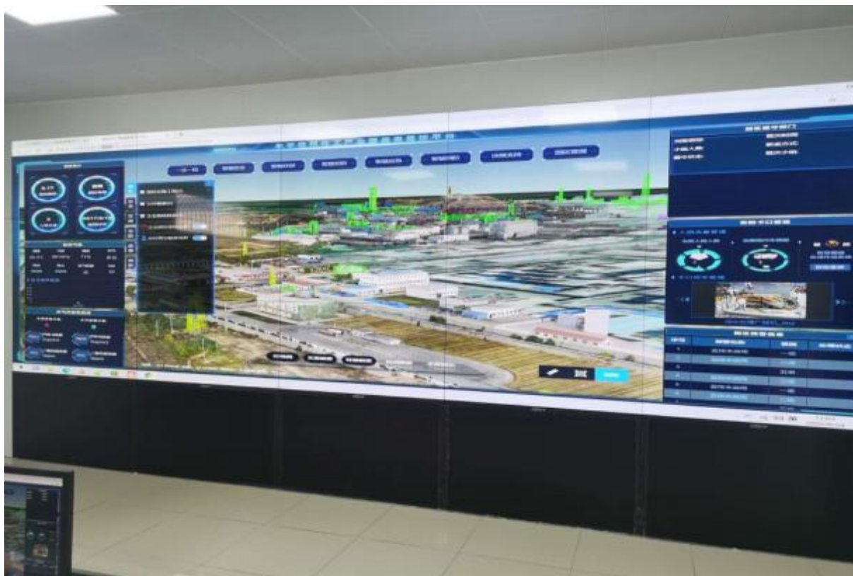
园区综合监管一体化平台
