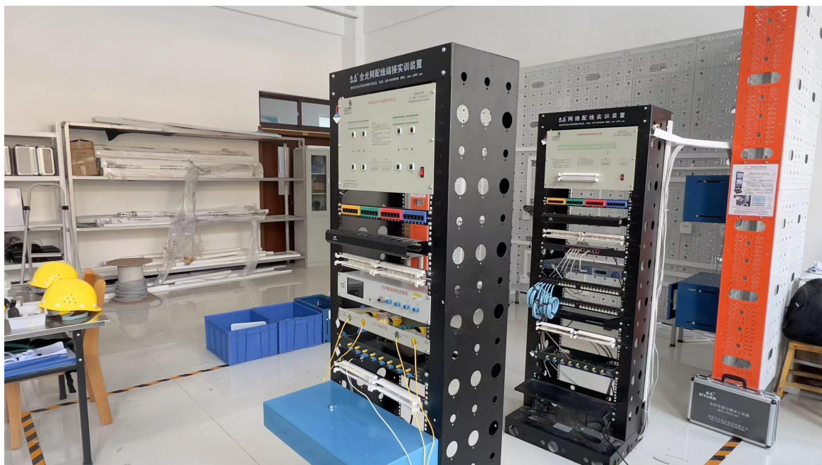
网络布线实训室
