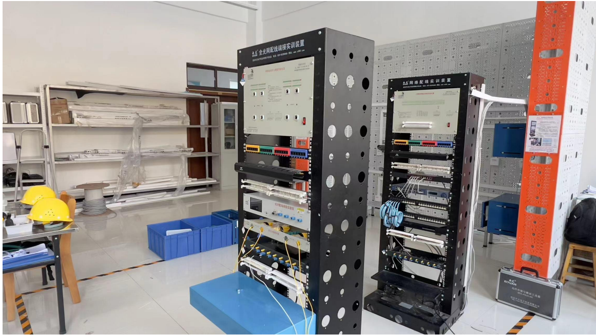
网络布线实训室
