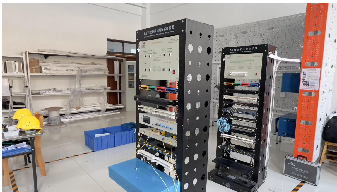
网络布线实训室
