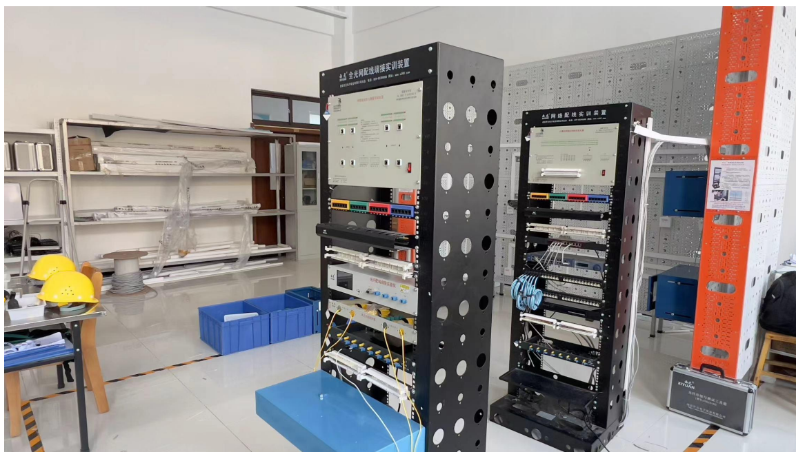
网络布线实训室
