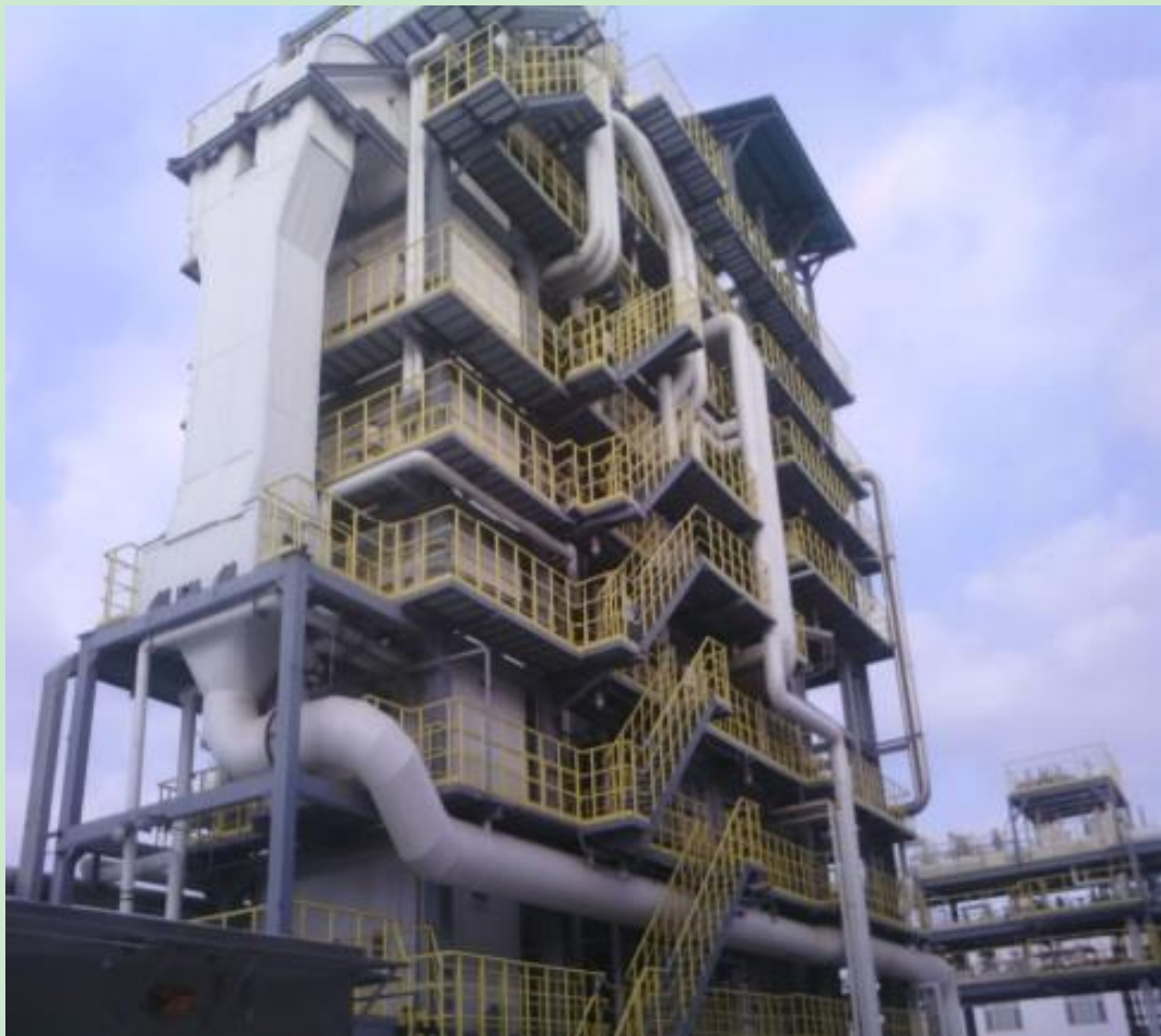
图 2.2.5-4 1#MMA 废水焚烧炉现状照片
