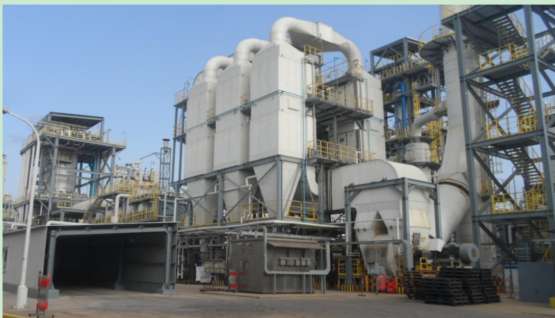
图 2.2.5-5 PCC 废水焚烧炉现状照片
