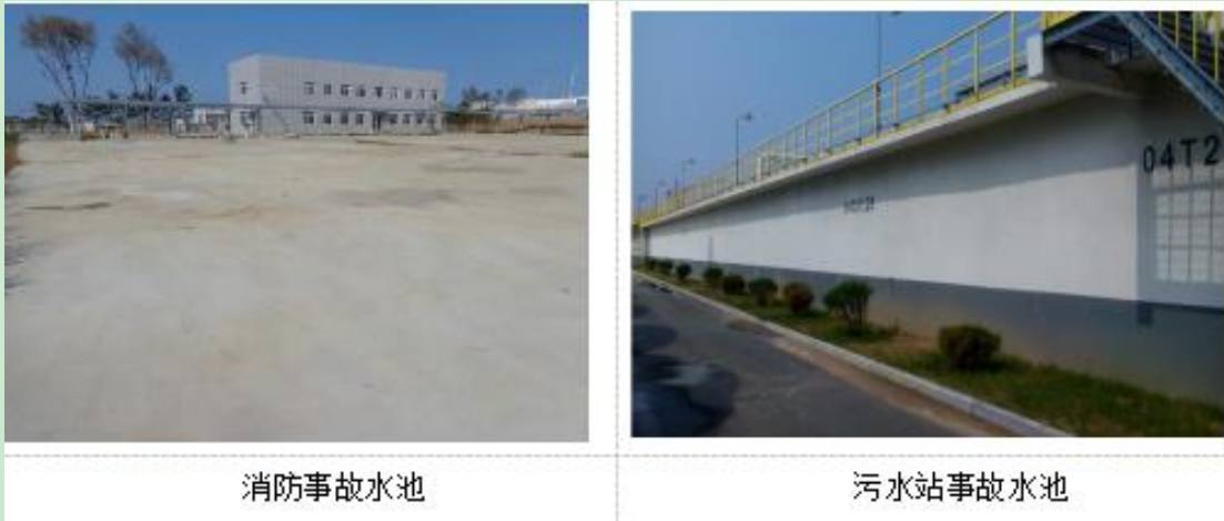
图 15.1.2-1 现有工程废水风险防范措施
