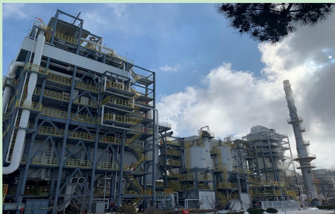
图 2.2.5-2 TDI 能量回收装置现状照片
