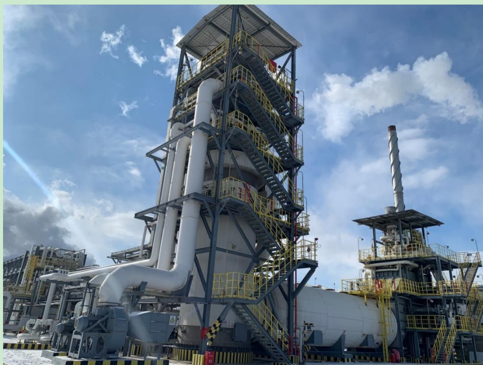
图 2.2.5-3 1#焚烧炉装置照片
