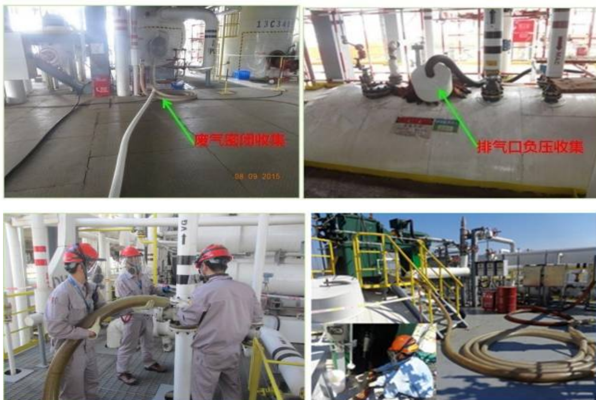
图 3.2-5 检修时废气软管收集设施
