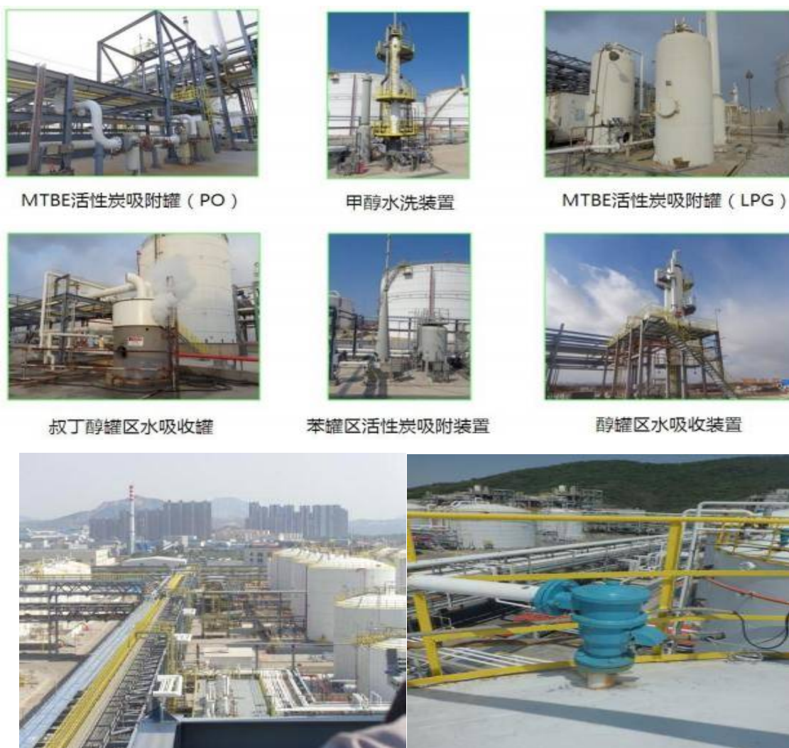
图 3.2-4 储罐安全阀排气收集
