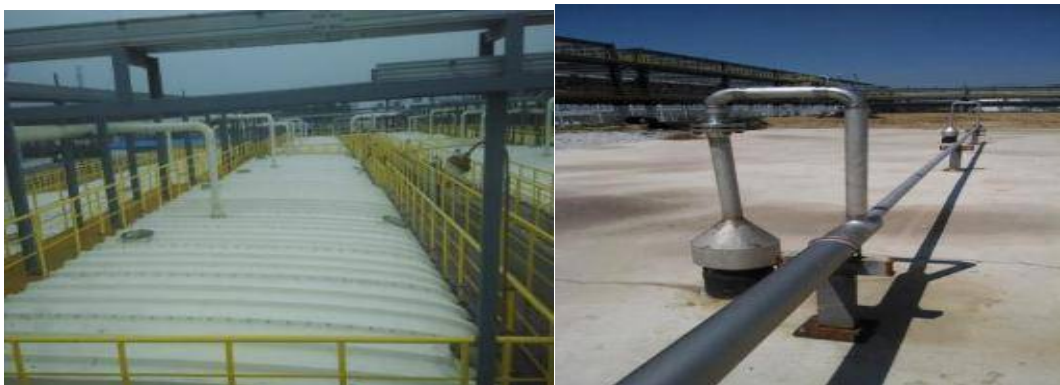
图 3.2-7 污水处理系统、污水池废气收集设施
